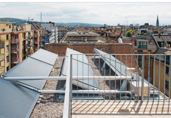
Sonnenkollektoren auf dem Dach erwärmen im Sommer bis zu 80 Prozent des Warmwassers.
